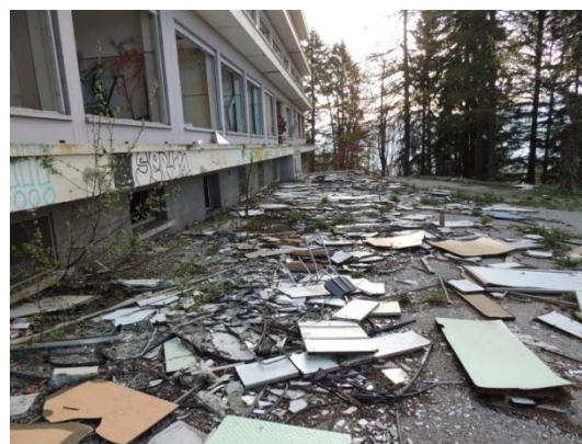
Figure 1 - Débris accumulés au pied d'un bâtiment
