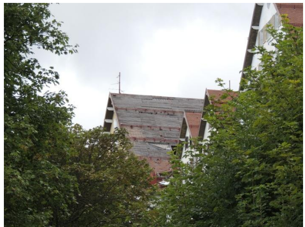
Figure 7 – L'un des bâtiments privé de tuiles
