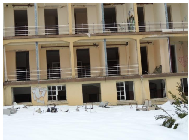
Figure 9 - Bâtiment vandalisé avec accumulation de matériel médical jeté depuis les fenêtres
